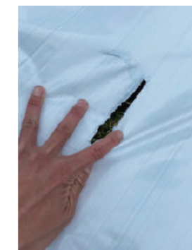
⑥6月23日 スタック破れ状況
