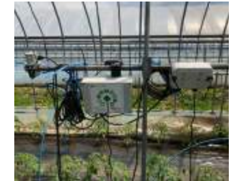
ハウス内環境計測:みどりクラウド
