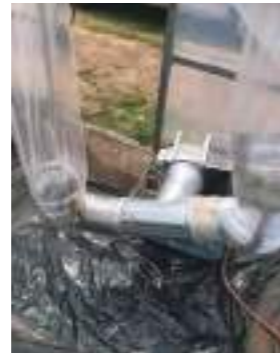
②CO 2 発生機設置状況
