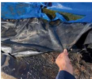
H30.9.11 展張後シートの様子
