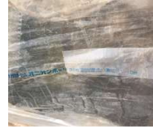
⑤オニオンホット 裂けた箇所
